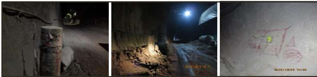
Şekil 6. 10 Honaz Tüneli içindeki pilyeler ve konsol (sağ)
