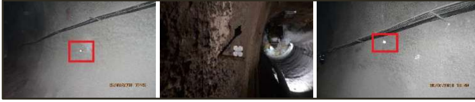
Şekil 4. 3 Tünel içinde kullanılan deformasyon noktaları (Denizli Honaz Tüneli)
